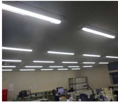
LED照明への切替え
