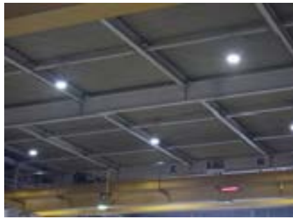
LED照明への切替え (プラ金型工場)
