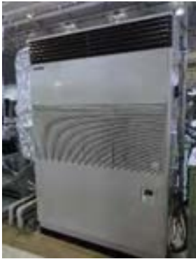
省エネ エアコンへの切替え (プラ金型工場)
